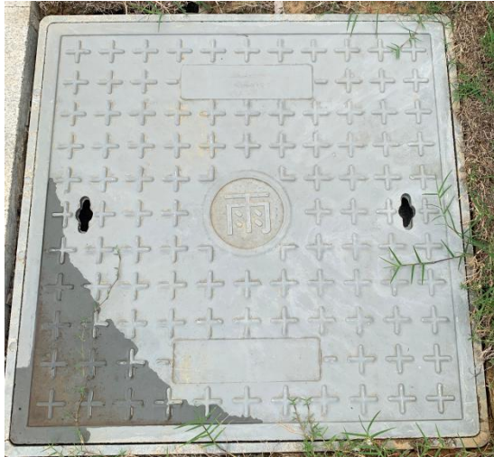
雨水管网接口
