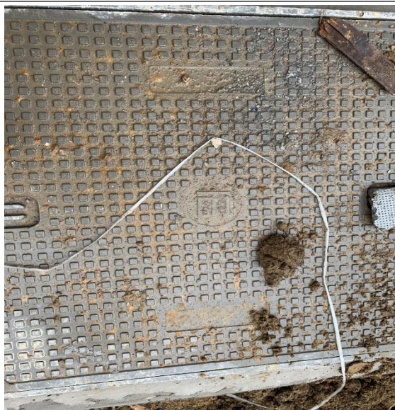
雨水管网接口
